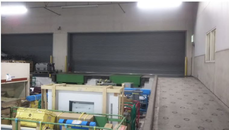
防犯シャッター
